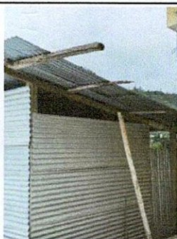
Foto 3: MODULO DE AULAS - El techo del aula esta en mal estado, hay filtraciones
