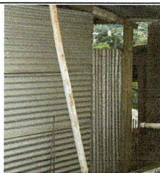
Foto 2: MODULO DE AULAS - Las condiciones de la puerta no son las adecuadas
