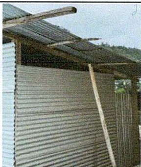
Foto 1: MODULO DE AULAS - Se encuentra en mal estado el cerramiento el aula
