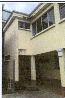
Foto 5: MODULO DE AULAS - Las superficies de los muros presentan desgaste y pérdida de recubrimiento de pintura
